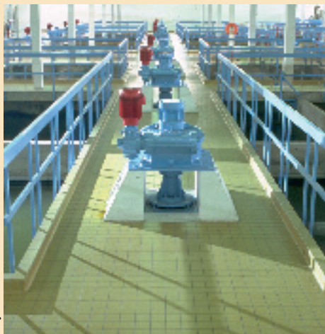
© Syndicat des Eaux d'Ile-de-France
